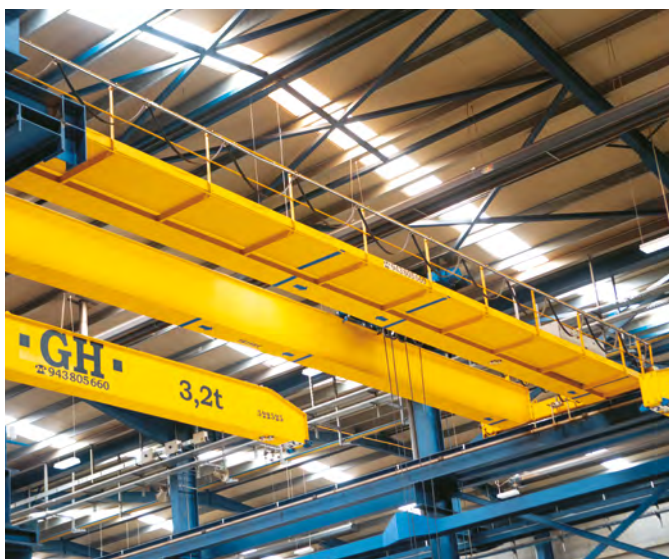
维修走台 小车平台
