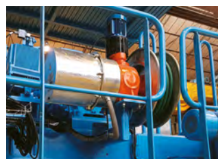
集成安装的电缆卷筒
